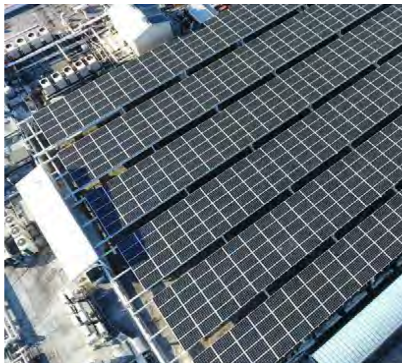
Instalación fotovoltaica en Centro Comercial Pradera en Zacapa
